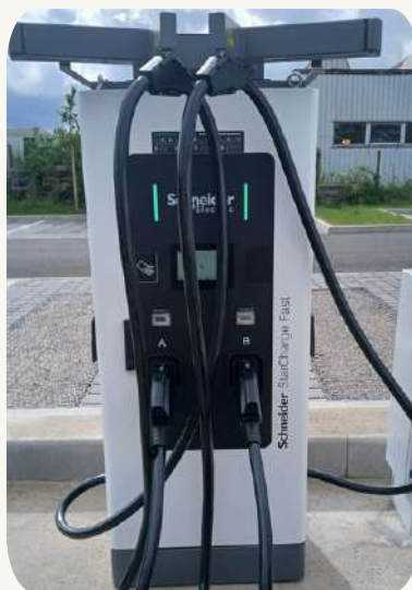
Borne de recharge électrique installée par GED EMV
